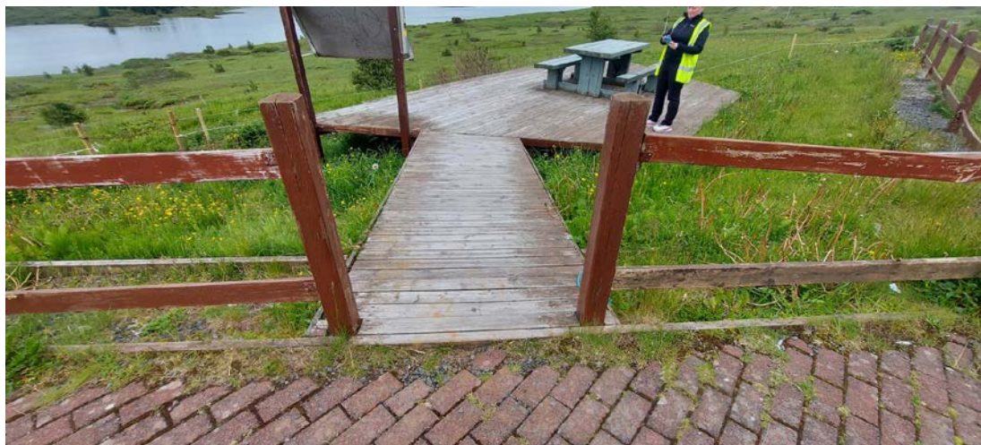
Mynd 4.48 Útsýnispallur við áningarstaðinn er orðinn lúinn og slyshætta ef gestir stíga fram af brún hans.
